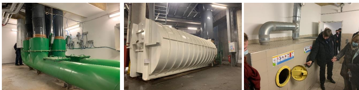
Exemple de réseau souterrain, terminal conteneur et bornes logements installés à Issy-les-Moulineaux
